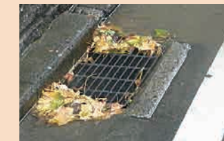
落葉による集水の阻害
