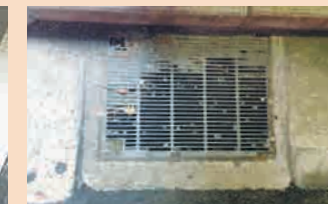
小石による目詰まり
